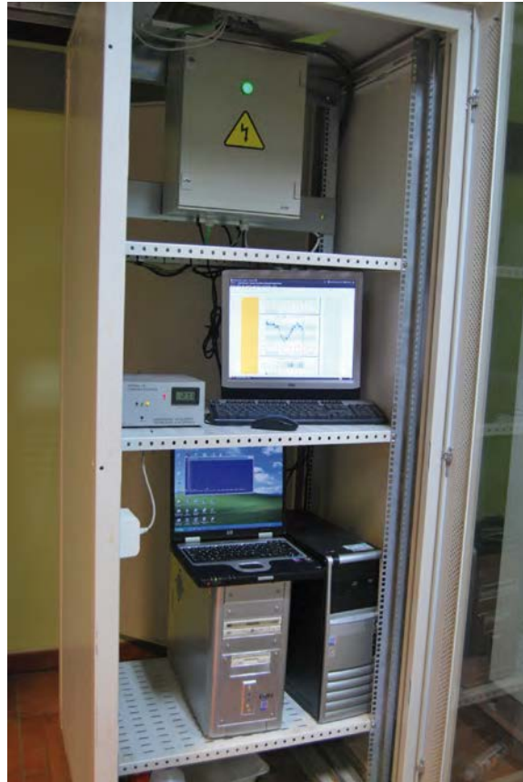
Figura 5. Armario de la Estación Central de control.
