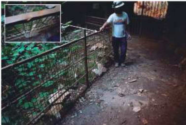
Figura 6. Caída de piedras (algunas de más de 30 centímetros) en el recorrido visitable de la mina de La Jayona. En la imagen superior izquierda, el impacto sobre la barandilla.
