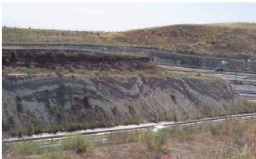
Figura 6. Pliegues producidos por deformación plástica por subsidencia en yesos miocenos de la Cuenca del Tajo (autovía M-45, SE de Madrid).
