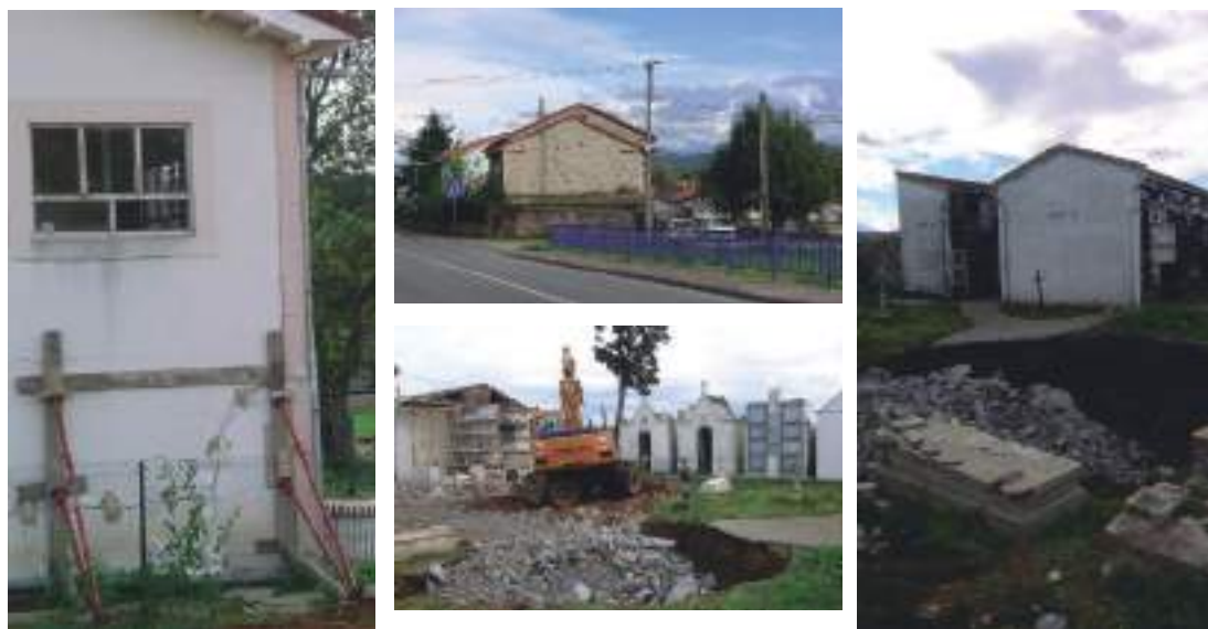
Figura 4. Imágenes de los desperfectos del año 2006: arriba viviendas, abajo el cementerio de Muriedas.
