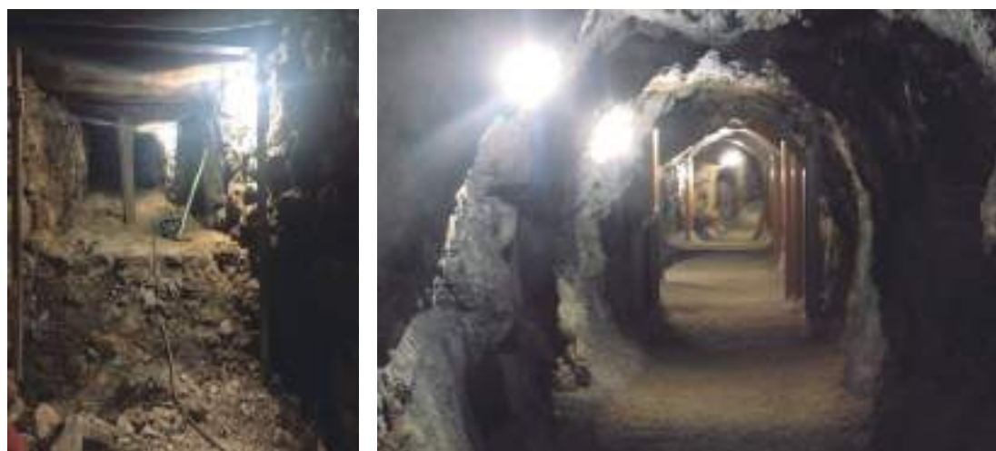
Figura 1. Izquierda: galería principal colmatada de lodos y escombros. Derecha: entibados en la galería principal en la actualidad (fotos: TECMINSA)
